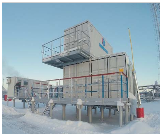
Рис. 2. Установка Flottweg на ОАО «Севернефтегазпром»
